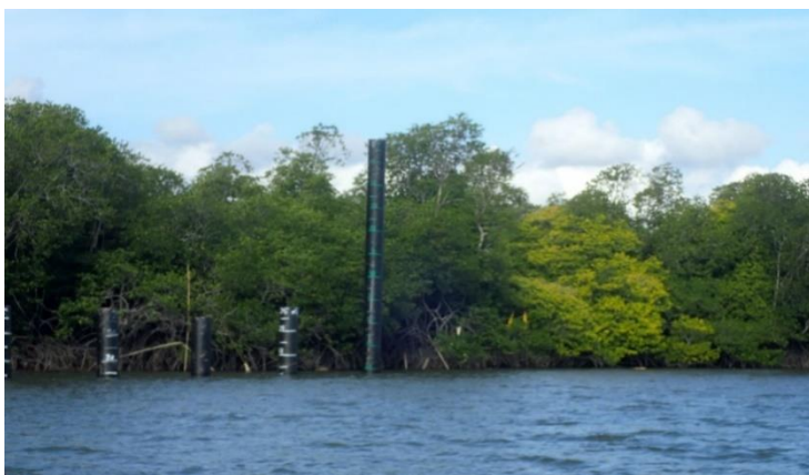
Potrubí pro rozšíření přístaviště společnosti PT ITCI Hutani Manunggal se přiblížilo ke žlutým mangrovům na přibližně 10 metrů.
